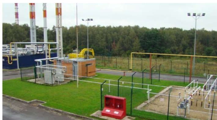
Рис. 1. Мини-ТЭЦ с газопоршневыми двигателями
